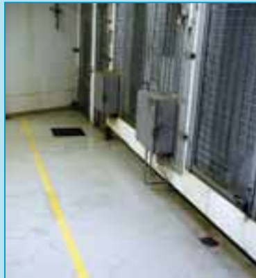
Falls der Kontakt im Bediengang nicht durch die Gehegeeinfriedung verhindert ist, kann durch eine farbliche Markierung der notwendige Sicherheitsabstand markiert werden.
