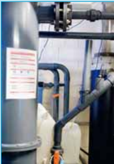
Wasseraufbereitungsanlage mit Betriebsanweisung
