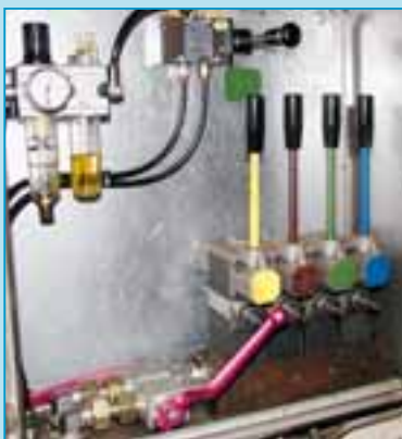
Eindeutige Zuordnung der Bedienelemente eines hydraulischen Schiebers durch farbliche Kennzeichnung
