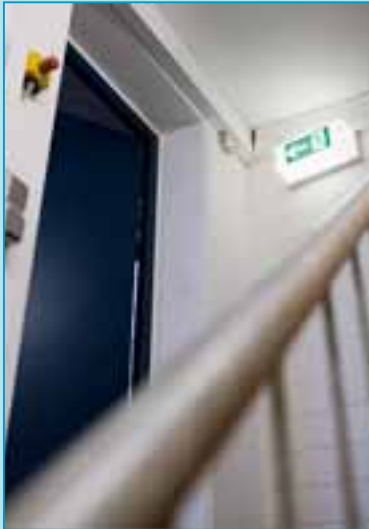
Gekennzeichneter Rettungsweg im Beschäftigtenbereich
