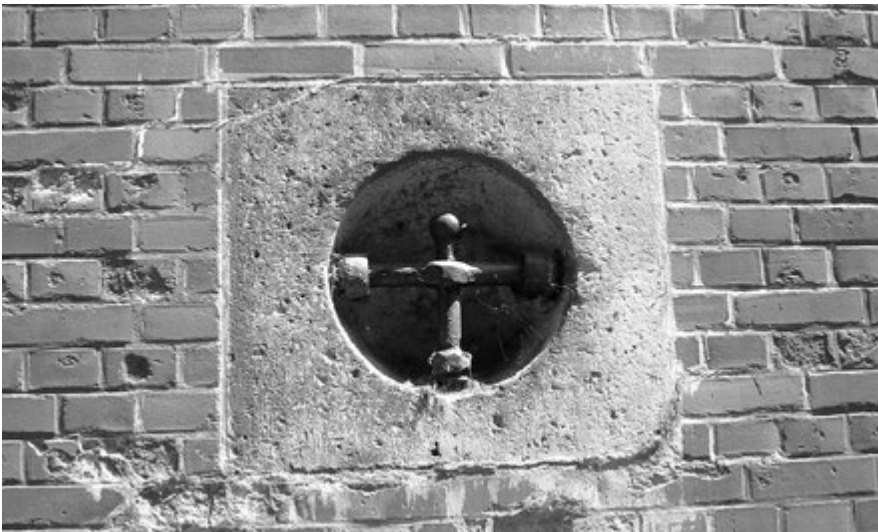
Abbildung 4: Alter Kreuzpoller – Kommt nur noch in alten Hafenanlagen vor. Vor Benutzung auf sicheren Zustand achten!
