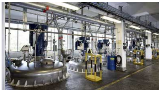
Abbildung 8: Produktionsanlagen mit geschlossenen Rührkesselreaktoren
