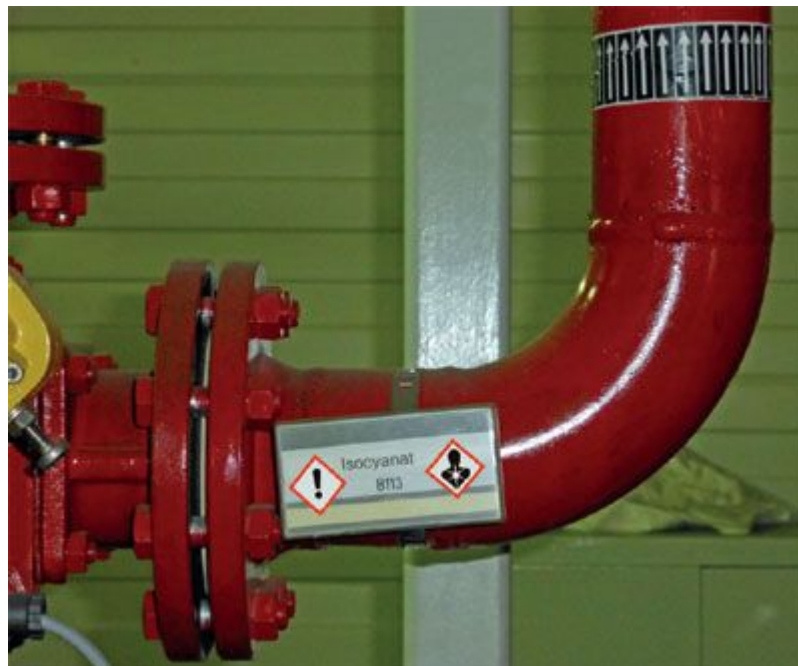
Abbildung 12: Kennzeichnung Isocyanat-Leitung mit Angabe der Durchflussrichtung
