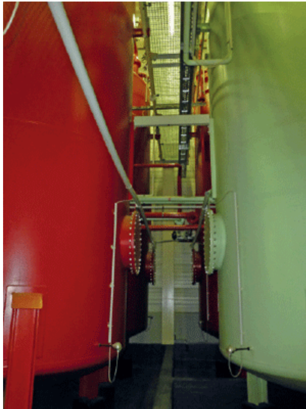
Abbildung 7: Unterschiedliche farbliche Kennzeichnung Isocyanat-Tank (rot) und Polyol-Tank (weiß)
