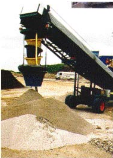
Abb. 10: Staubschutz durch Verminderung der Fallhöhe
