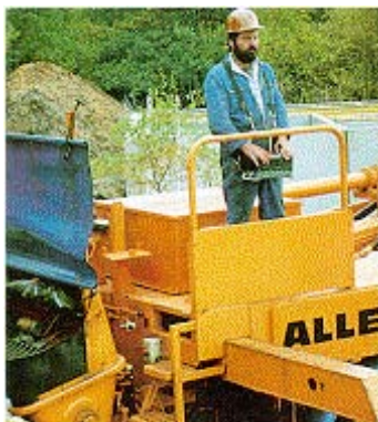
Abb. 29: Sicherer Standplatz auf der Pumpe
