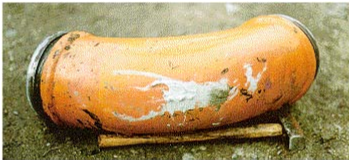
Abb. 27: Ausgebauter Leitungsbogen mit Leckstelle
