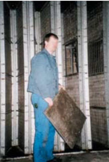
Bild 5-12: Filterwechsel an einer RLT-Anlage
