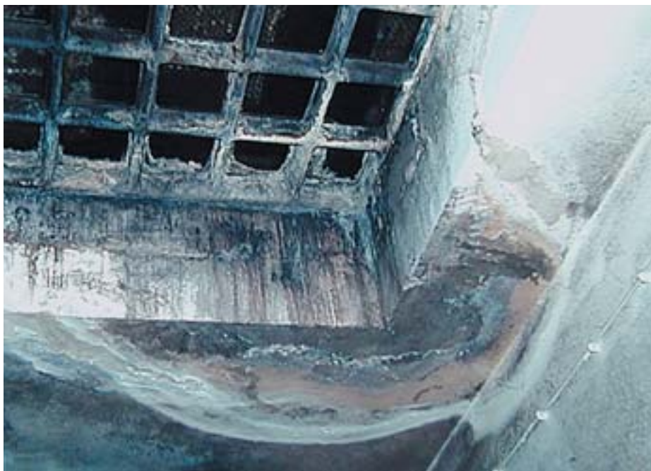
Bild 5-19: Bautechnisch bedingter Feuchteschaden mit Schimmelpilzbefall
