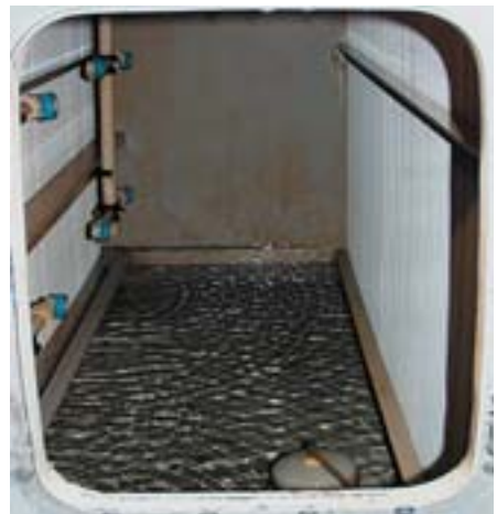
Bild 5-11: Blick in den Luftwäscher einer RLT-Anlage
