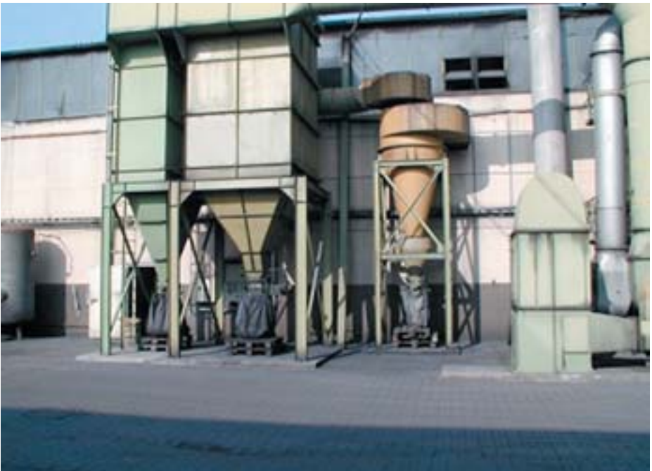
Bild 3-4: Filteranlage einer Buntmetallgießerei
