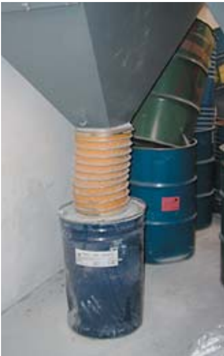
Bild 5-17: Filterauslass in einer Buntmetallgießerei
