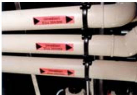
Bild 3-4: Kennzeichnung von Rohrleitungen
