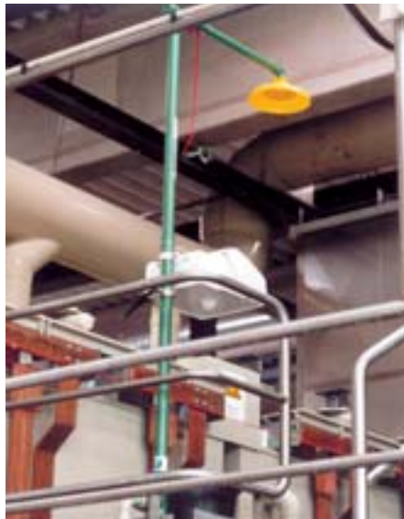
Bild 9-1: Augendusche und Dusche am Zugang zum Wartungsgang
