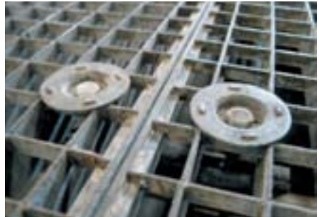
Bild 3-3: Sicher befestigte Bodenroste
