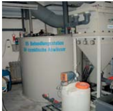
Bild 6-2: Abwasserbehandlungsanlage für cyanidische Abwässer
