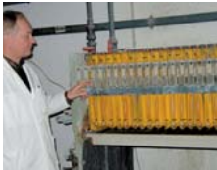
Bild 11-1: Die Filterpresse. Auch solche Betriebseinrichtungen müssen regelmäßig geprüft werden
