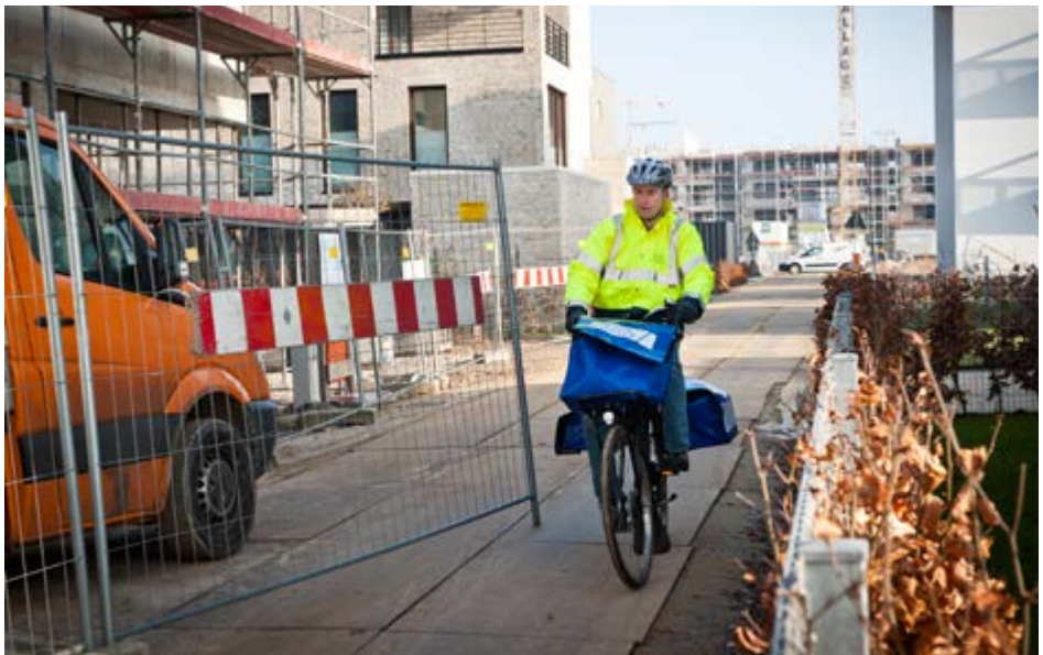
Abb. 3 Gefahr im Baustellenbereich
