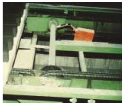
Abb. 35: Allseitige Verdeckung von Transportketten
