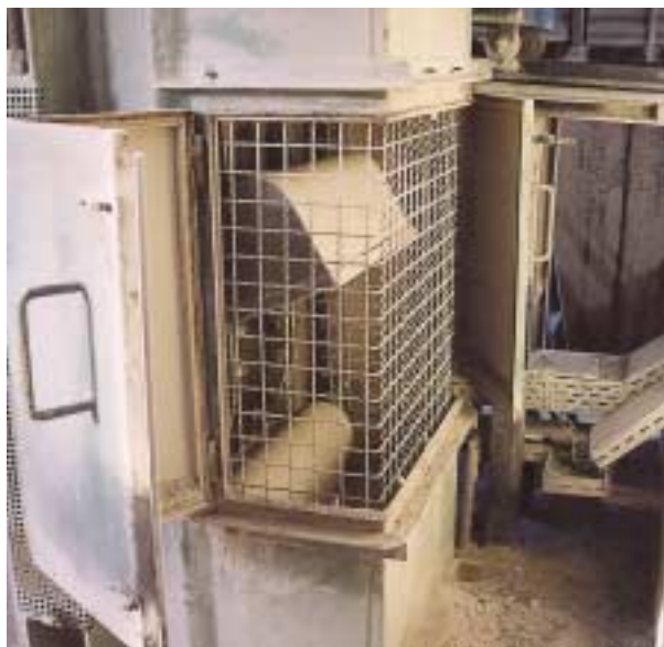
Abb. 39: Schutzgitter an einer Schauöffnung
