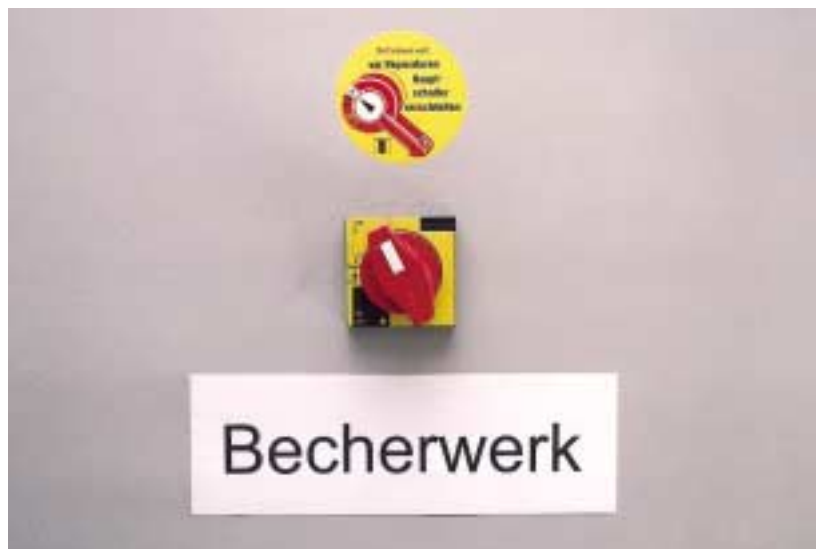
Abb. 46: Eindeutig gekennzeichnet: der Hauptschalter
