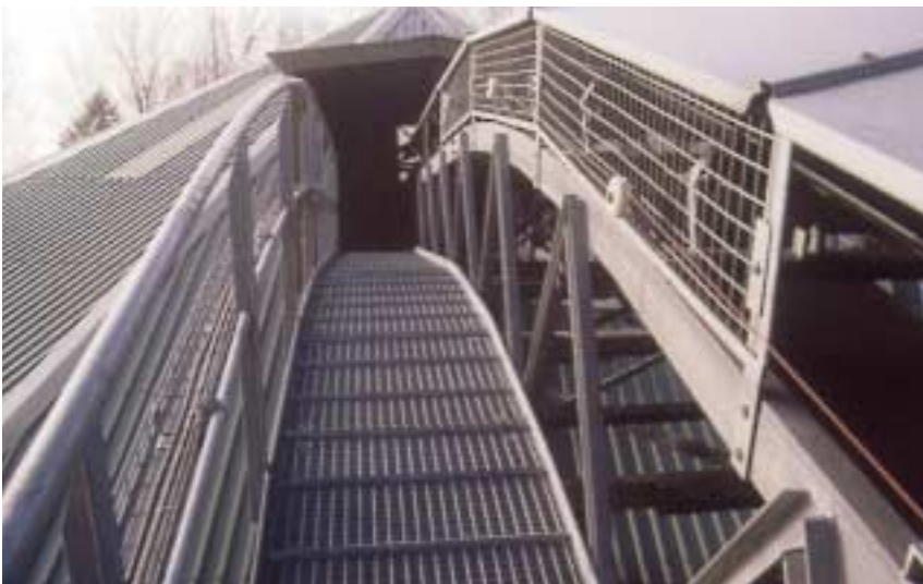
Abb. 15: Seitliches Schutzgitter an einer Bandabknickung
