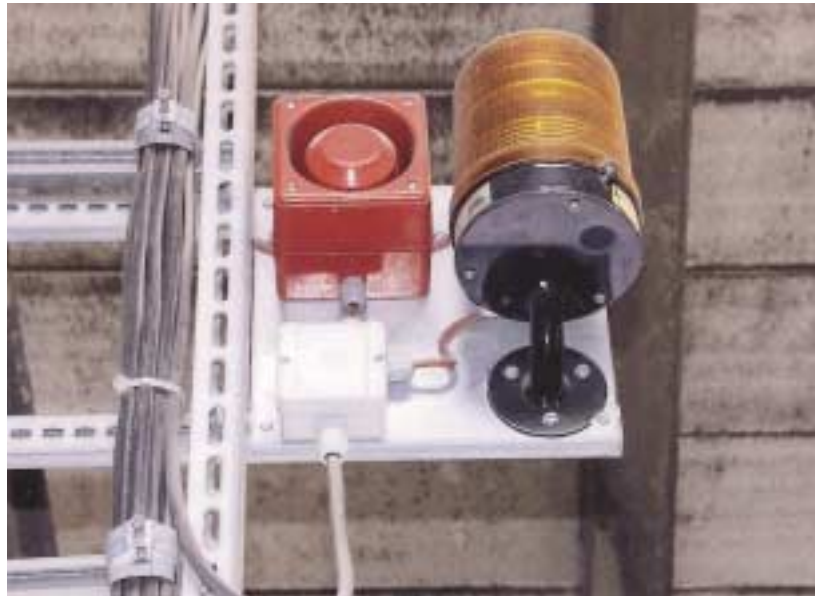
Abb. 20: Akustische und optische Anlaufwarneinrichtung
