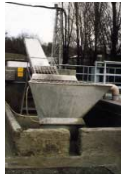
Abb. 42: Recycling-Anlage mit Austragsschnecke
