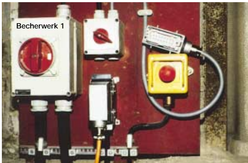
Abb. 40: Vor-Ort-Schalteinrichtung an einem Becherwerk
