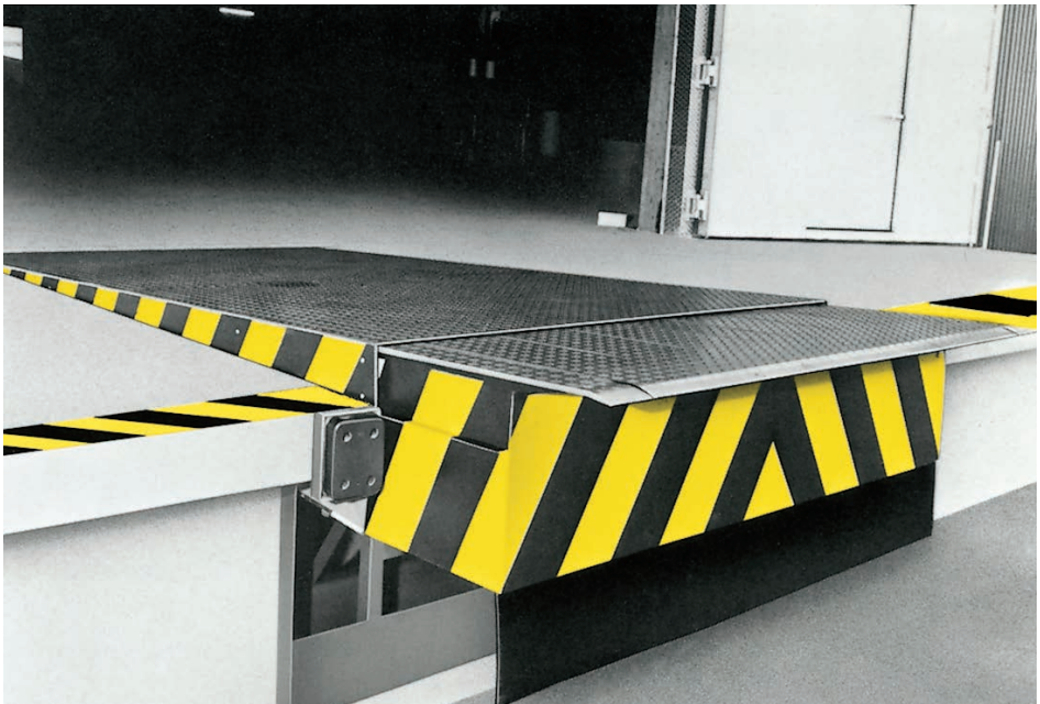
Bild 5: Sicherung von Quetsch- und Scherstellen.
