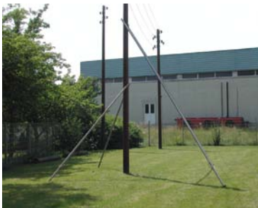
Bild 17: Einsatz von Folgestangen Zusätzlich werden Maste ohne nachgewiesene Standsicherheit gegen ein Ausweichen des Mastfußes gesichert.
