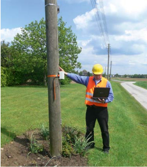
Bild 12: Beispiel für ein Messverfahren: Berechnung der Kopfpunktverschiebung und Bewertung eines Holzmastes durch Frequenzmessungen. Das Verfahren berücksichtigt Belastungen infolge von Wind- und Zusatzlasten (Isolatoren, Beseilung) sowie von Montagelasten. Es ermöglicht eine Aussage über den Materialzustand und Einbaumängel.
