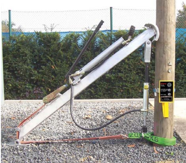
Bild 14: Beispiel für ein Messverfahren: Beurteilung des Materialzustandes an einem Holzmast mittels Krafteinleitung und Messung der Mastbewegung. Ein Warngerät sendet einen akustischen Alarm, sofern durch die Krafteinleitung eine unzulässige Neigung des Mastes eintritt.
