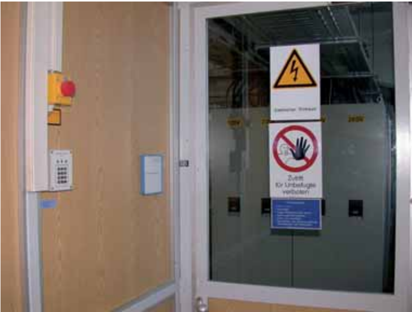
Bild 9 Zugang zu einem Dauerversuchsraum, Kennzeichnung der Zugangstüre, Zugang mittels codierter Türverriegelung nur für befugtes Personal
